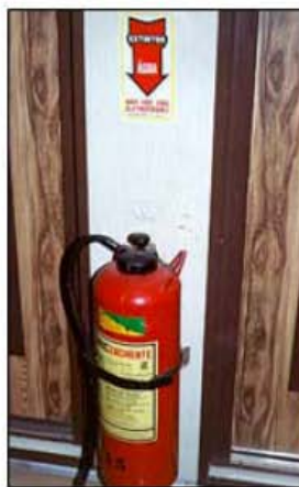
Extintor de água pressurizada
