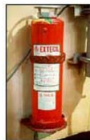
Extintor de espuma química
