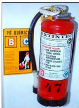
Extintor de PQS pressurizado
