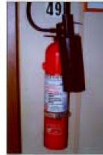
Extintor de CO 2
